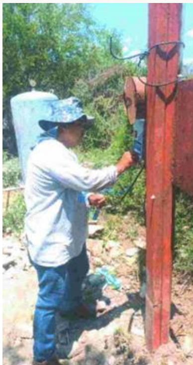
Bomba de agua Comunidad la Reforma
